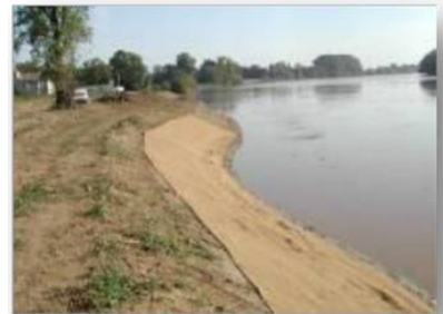
Mise en place d'un géotextile sur les berges de la Dordogne, sur le site de Condat, avant plantation
